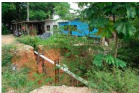
Grave erosión tiene en riesgo varias viviendas en Barrancabermeja
