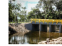
Nuevo box culvert y obras de mitigación del riesgo en Restrepo, entregó Gobernadora Rafaela Cortés
